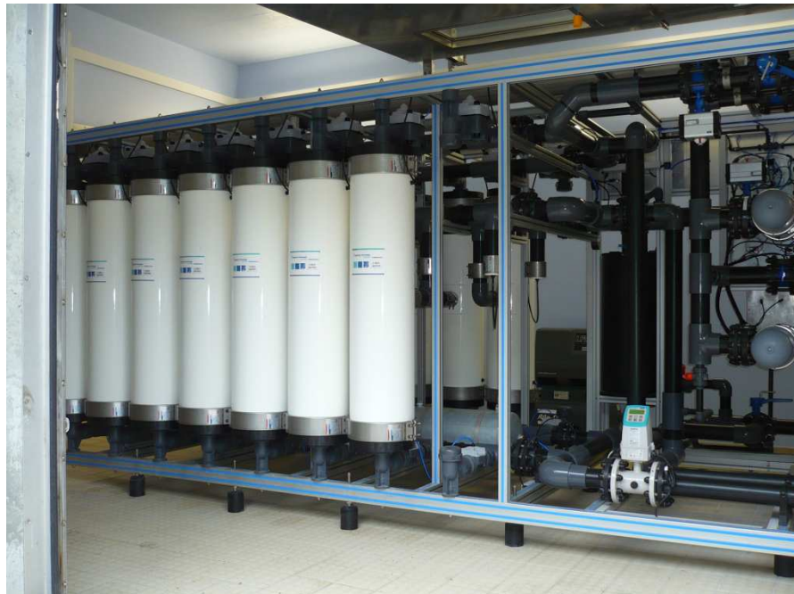
Photo 1 : Modules d’ultrafiltration en place sur la station de traitement de Saint Michel Lès portes
